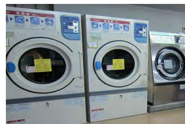
メインの洗濯作業 ↑ 洗濯機&乾燥機です
