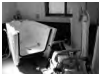
機械浴 身体的に入浴が困難な方でも安心して入浴いただける設備です。床暖房も設備しており寒い冬でも暖かく入っていただけます。
